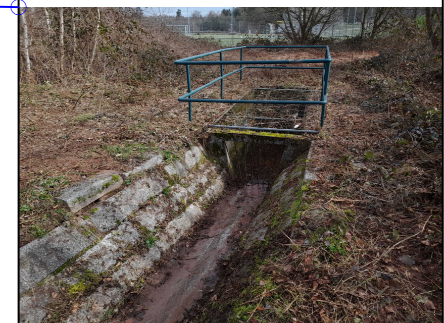
Sandfang vor Sportgelände, weiterführende Leitung DN1000
